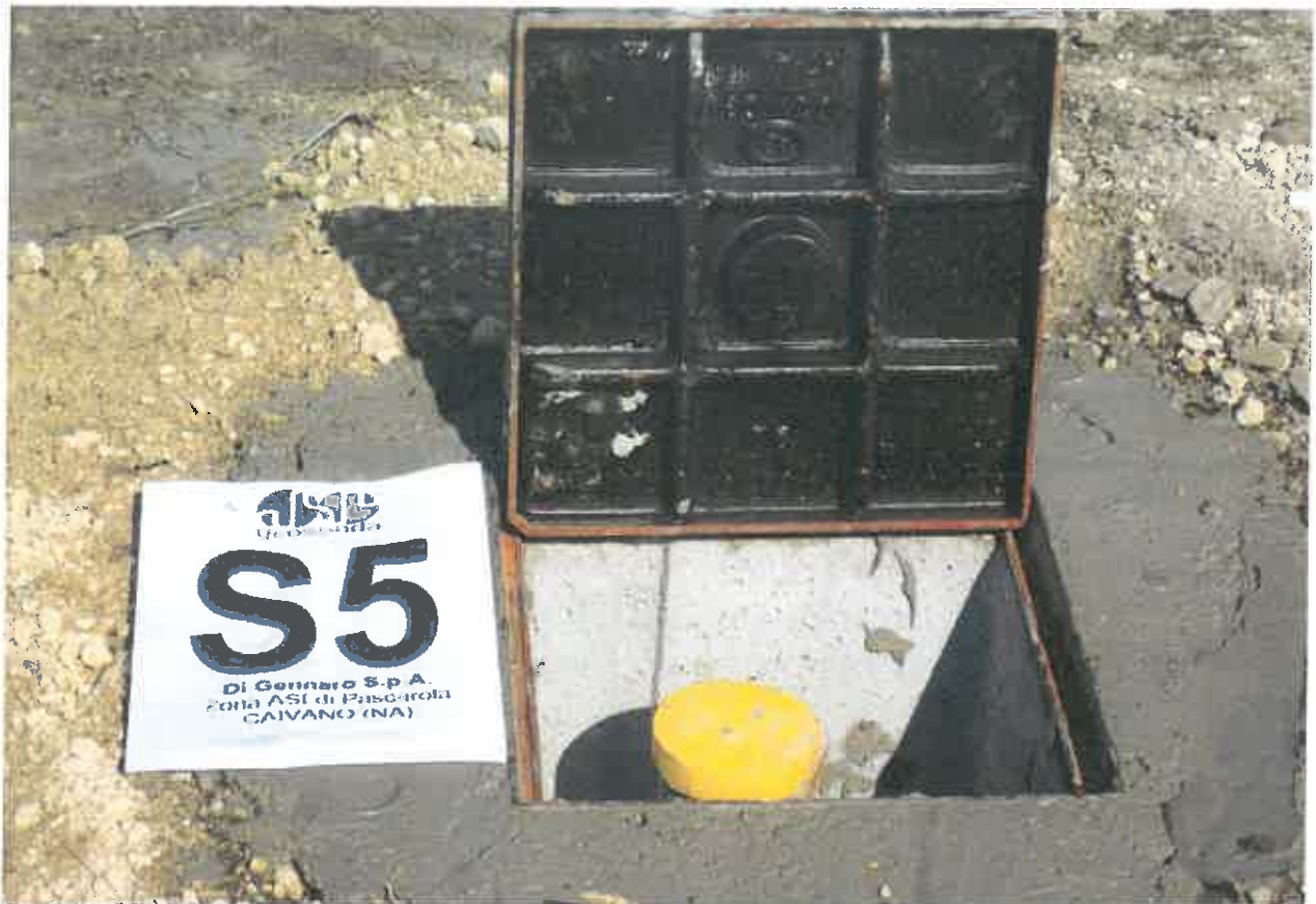
FOTO "23": Pozzetto per condizionamento S5.
