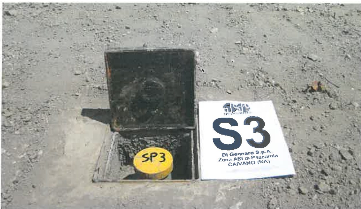
FOTO "13": Pozzetto per condizionamento SP3.
