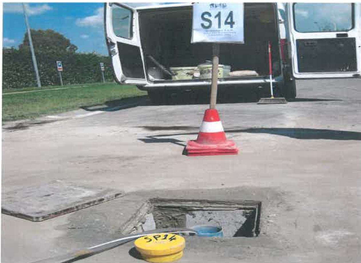
FOTO "61": Pozzetto per condizionamento SP14.
